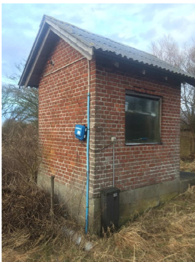
Gavl syd-vest med alarm lampe
