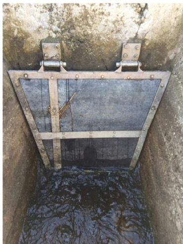
Kontraklap, som er meget utæt
